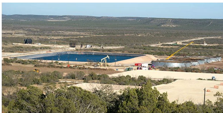
Рисунок 45 – Полигон по переработке и подготовке воды ГРП в компании Apache Corporation [14]
